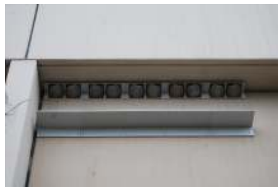
Schwalbennester an der Turnhalle
